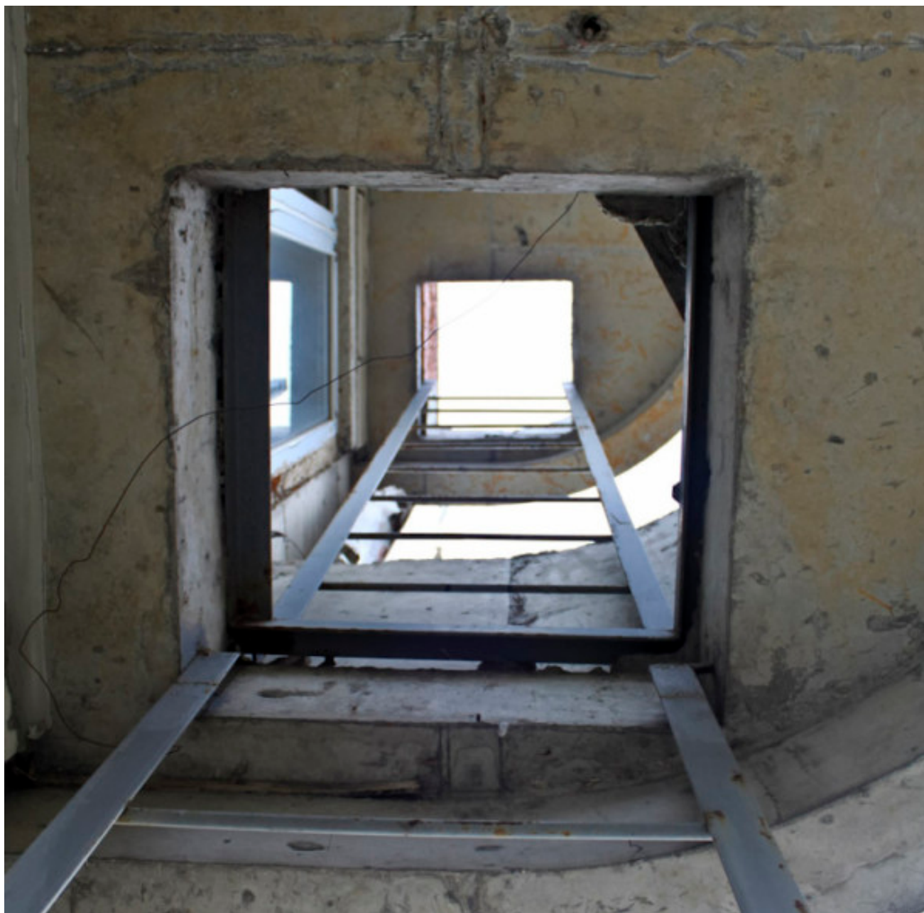
Противопожарная лестница на балконе. Аварийный выход.
